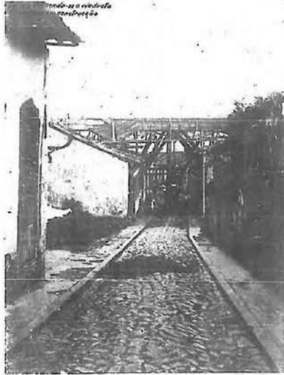
Viaduto em construção — ligando a Avenida Pedro Palmeiros à Praça do Quartel
