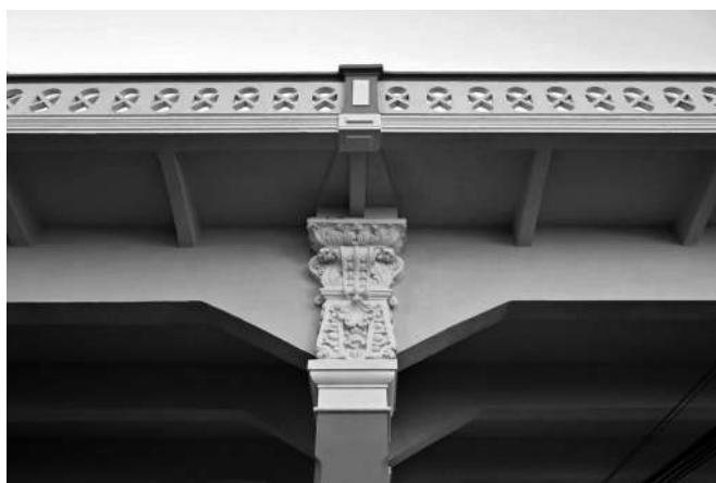
Figura 21 – Detalhe dos capitéis decorados dos pilares e as mísulas que os unem à viga longitudinal. Fonte – SEDEC/GPU/CRU, ago. 2023.
